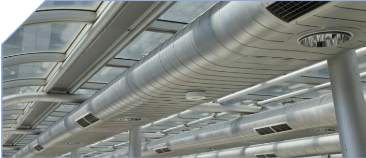
HAVALANDIRMA TESİSATI KONTROLLERİ
