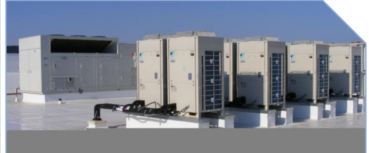
KLİMA TESİSATI KONTROLLERİ
